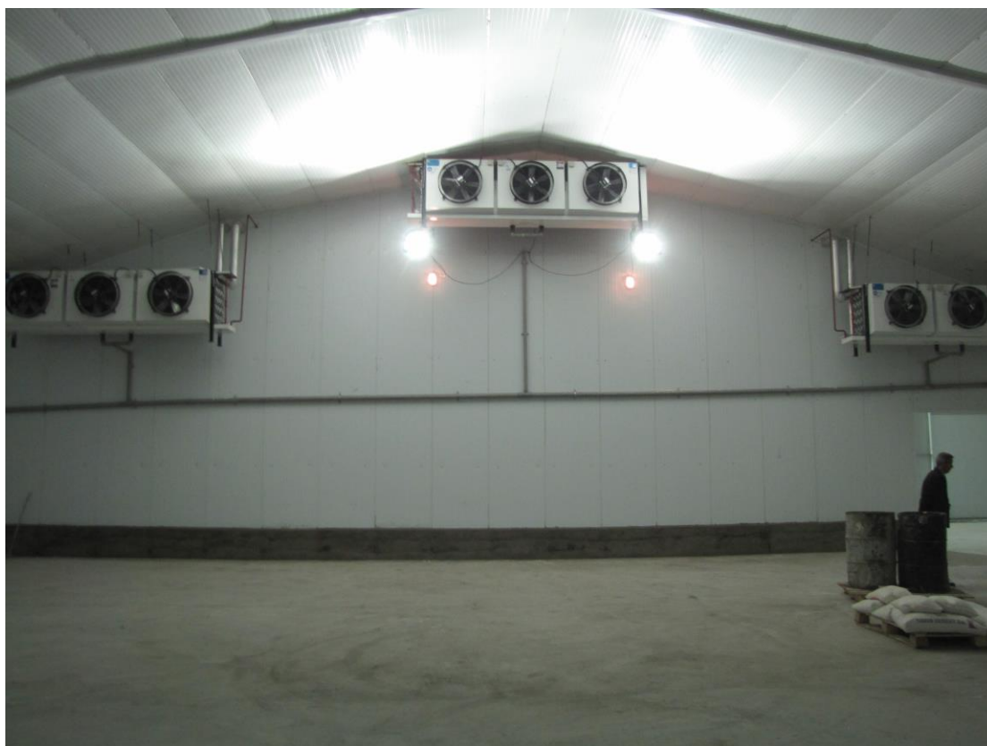
نصب اواپراتورهای ساخت تبادل سازان در سالن های نگهداری شرکت مزمز
